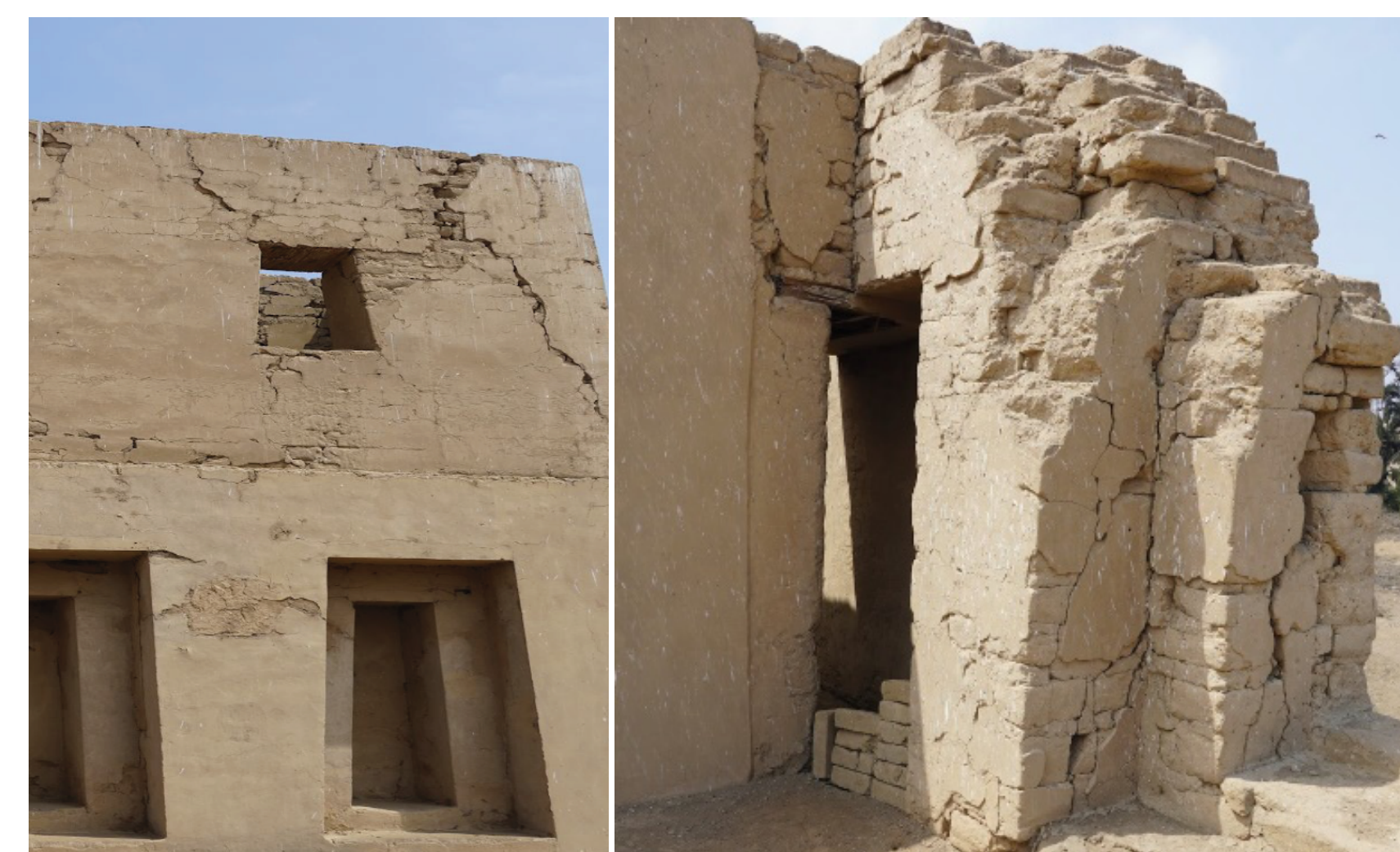
Vista del daño en algunos elementos.
