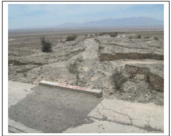
Alcantarilla 05 y erosión de la berma en la carretera
