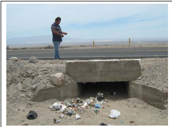
Alcantarilla 17 y desperdicios
