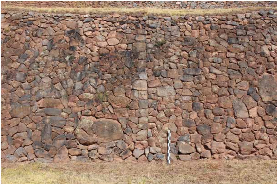
Figura 5. Muro de contención con junta de dilatación en el sector del K'alla Qhasa.
