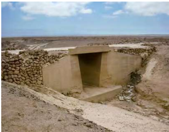
Foto 22. Vista del puente de piedra y concreto para facilitar el cruce de una pequeña quebrada
