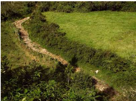
Foto 5. Desplazamiento del camino Levanto - Yálape en una cuesta.
