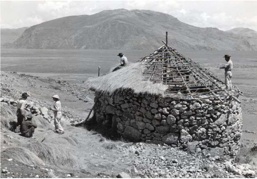
Trabajos de techado de una qollqa circular. (Tomado de Murra y Hadden, 1966)
