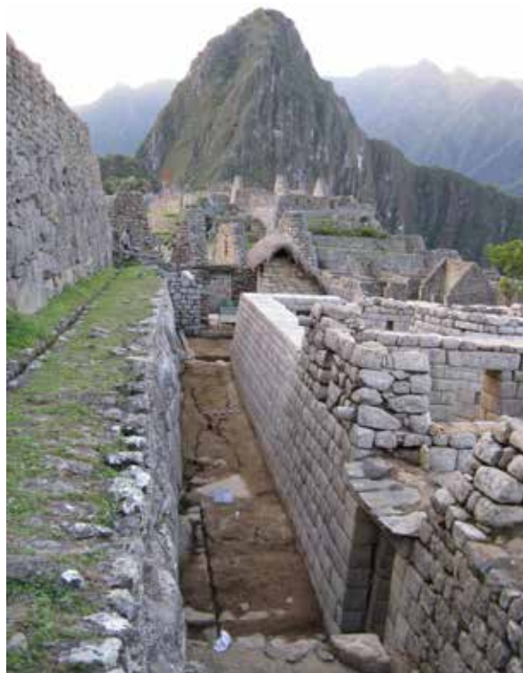
Figura 57. Fisuras evidenciadas durante la excavación del pasaje de ingreso al conjunto 15 (Templo del Sol) (fotografía: Piedad Champi).
