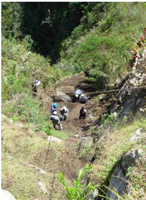
Figura 51. Vista general de las excavaciones en las terrazas del conjunto 17. El acceso para las labores fue posible con el apoyo de los especialistas de progresión vertical de la Asociación Ukhupacha (fotografía: Salvador Guinot).
