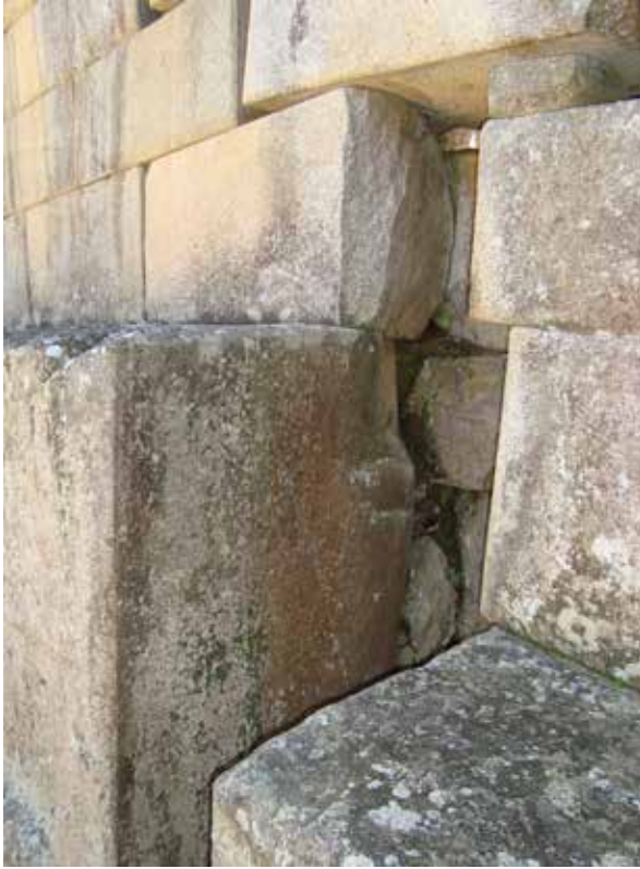
Figura 38. Detalle del Templo Principal: apoyo del muro del fondo sobre la pieza megalítica central, afectando 0.25 m de su espesor.
