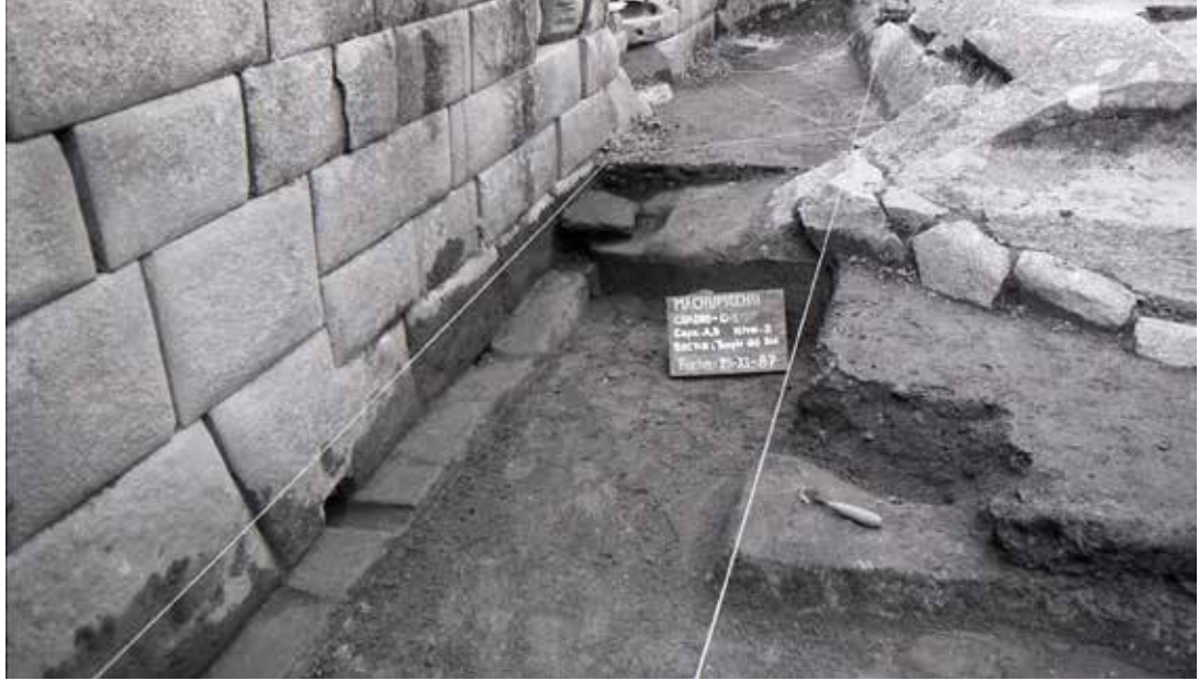
Figura 31. Dren del muro norte del Templo del Sol (señalado por la flecha) (fuente: Ramos 1987).
