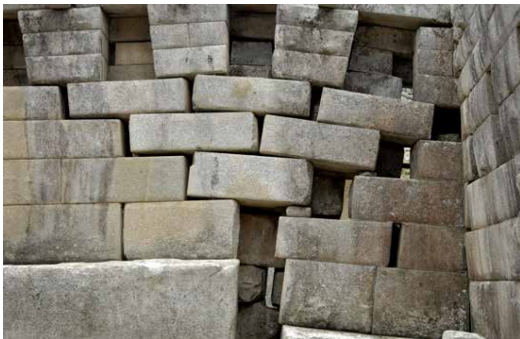
Figura 37. Detalle del Templo Principal: esquina derecha con hundimiento del muro y reacomodo de las piezas líticas ocasionado por la disminución de la resistencia del suelo.
