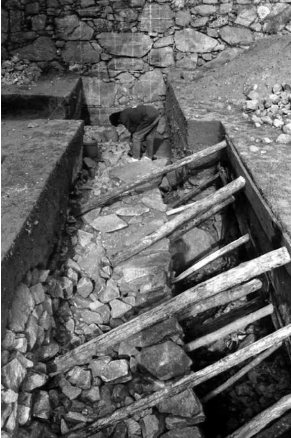
Figura 21. Se encontró un antiguo muro de piedra enterrado bajo una terraza, el cual probablemente fue hecho en el periodo inicial de construcción de la ciudadela. Nótese los fragmentos de piedra de desecho que se utilizaron para rellenos y drenajes del subsuelo.
