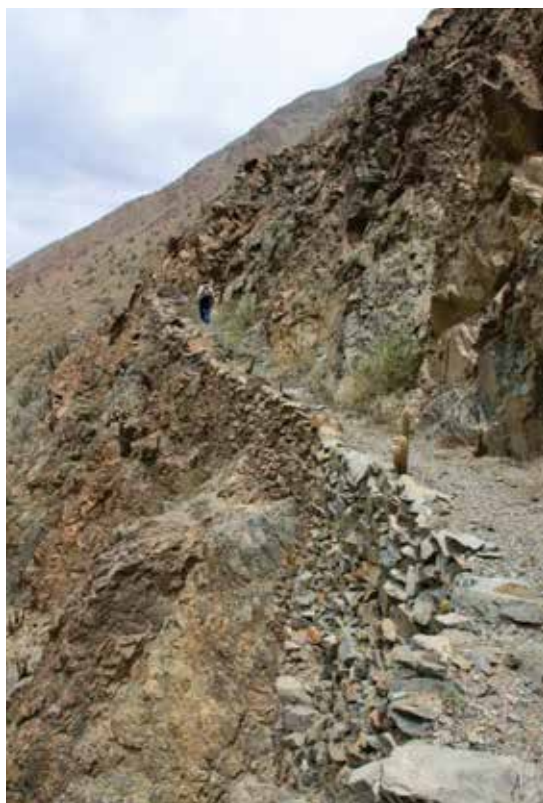
Fig. 75. Camino transversal que presenta corte en talud, tramo Xauxa - Pachacamac. Foto Qhapaq Ñan Perú.
