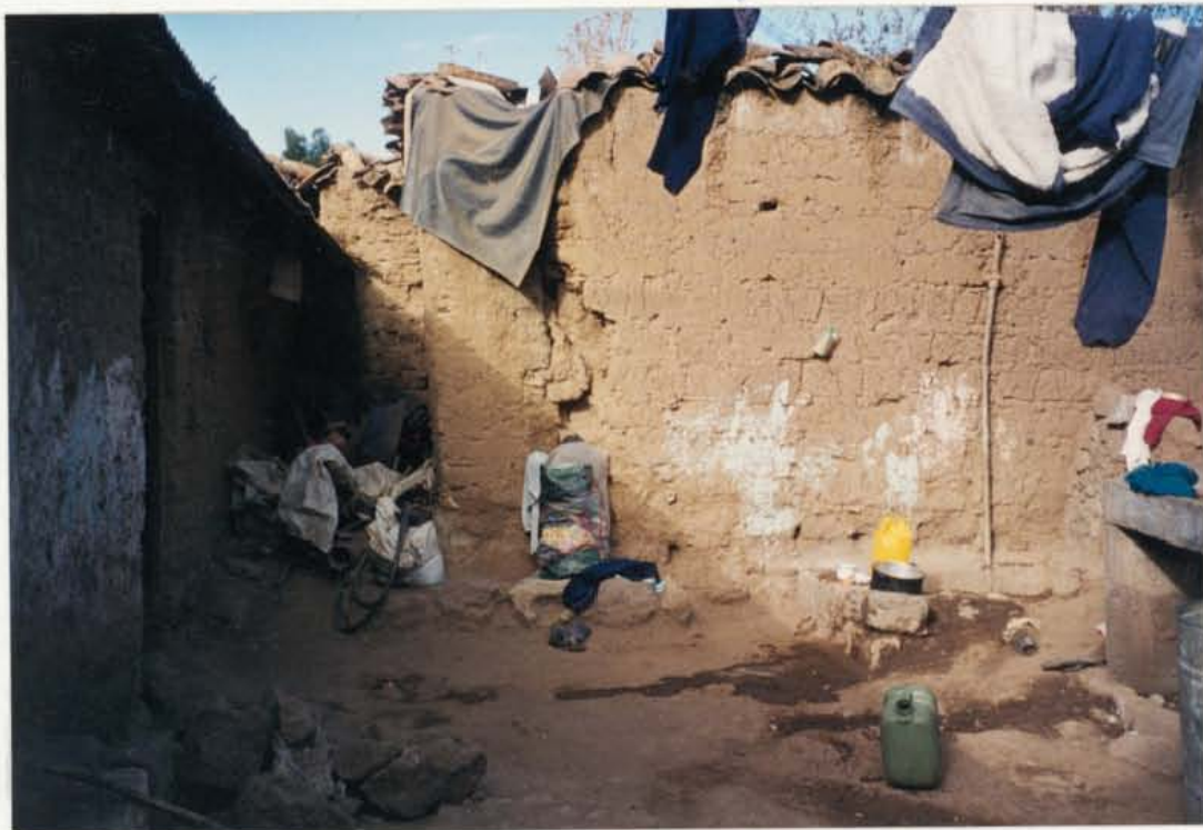
FOTOGRAFIA N° 3. : MUROS AGRIETADOS DE AMBIENTES DEL INTERIOR
